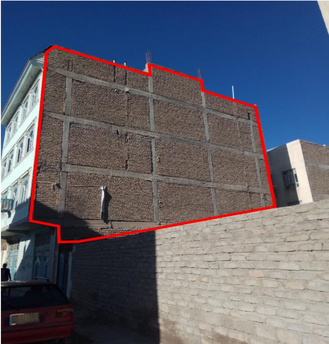
рис. 1.4.6: показана неизолированная восточная стена четырехэтажного жилого дома.
