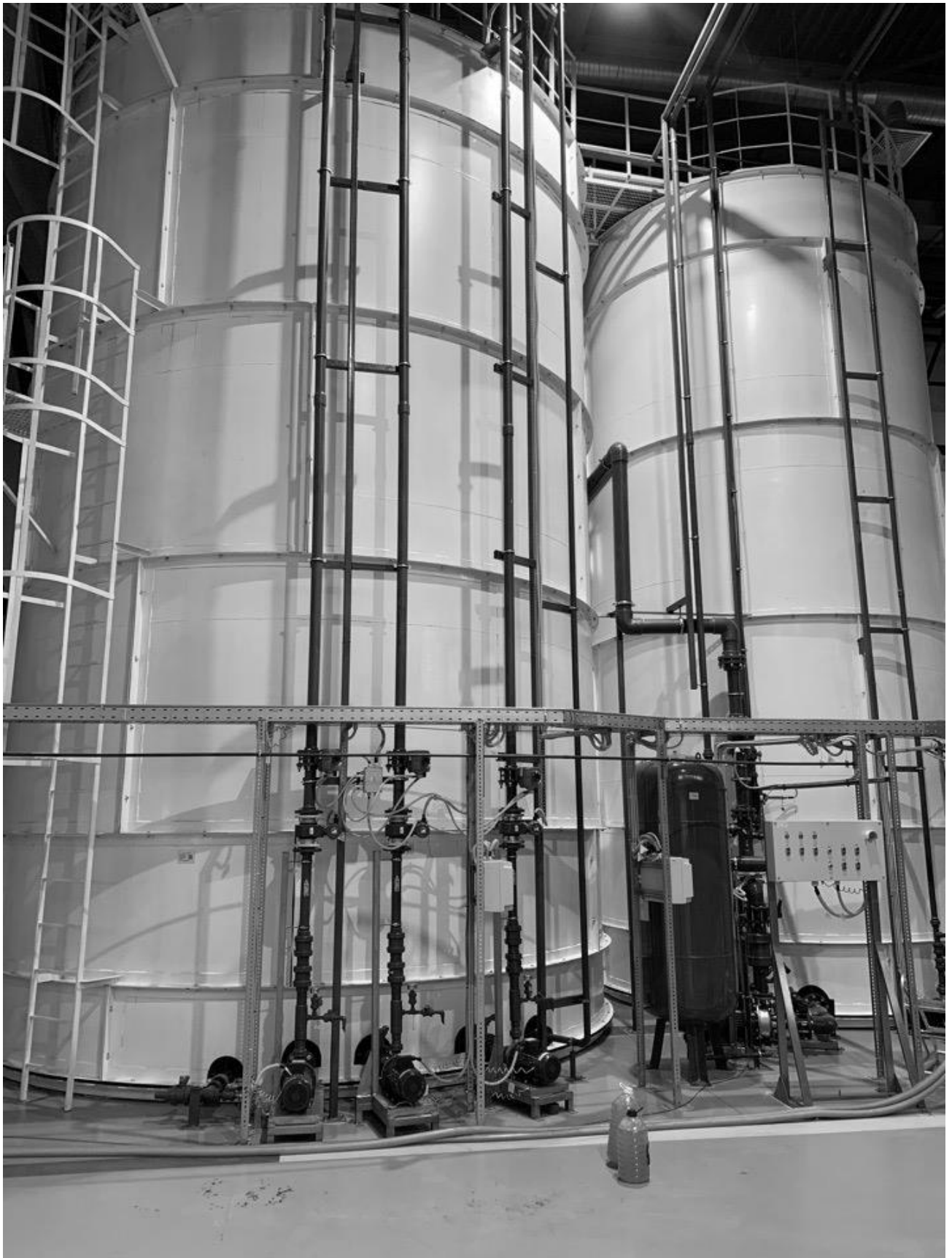
Рисунок 3.2 – Накопительные резервуары промывных вод
