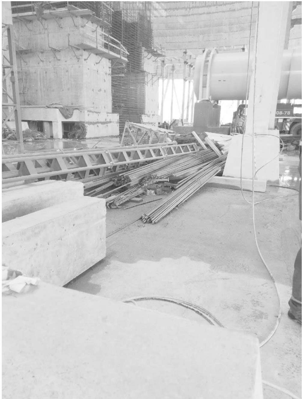
Рис. 12 Вид на не смонтированные ригели. На заднем плане расположены красные стойки для поддержки и изменения положения колонн в стакане.
