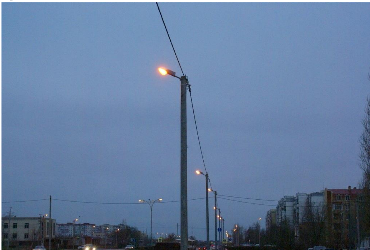
Рисунок 3 – Уличное освещение выполненное проводом СИП
