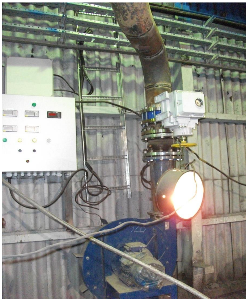
Рисунок 1.7 – Дутьевой вентилятор с запорно-регулирующей арматурой
