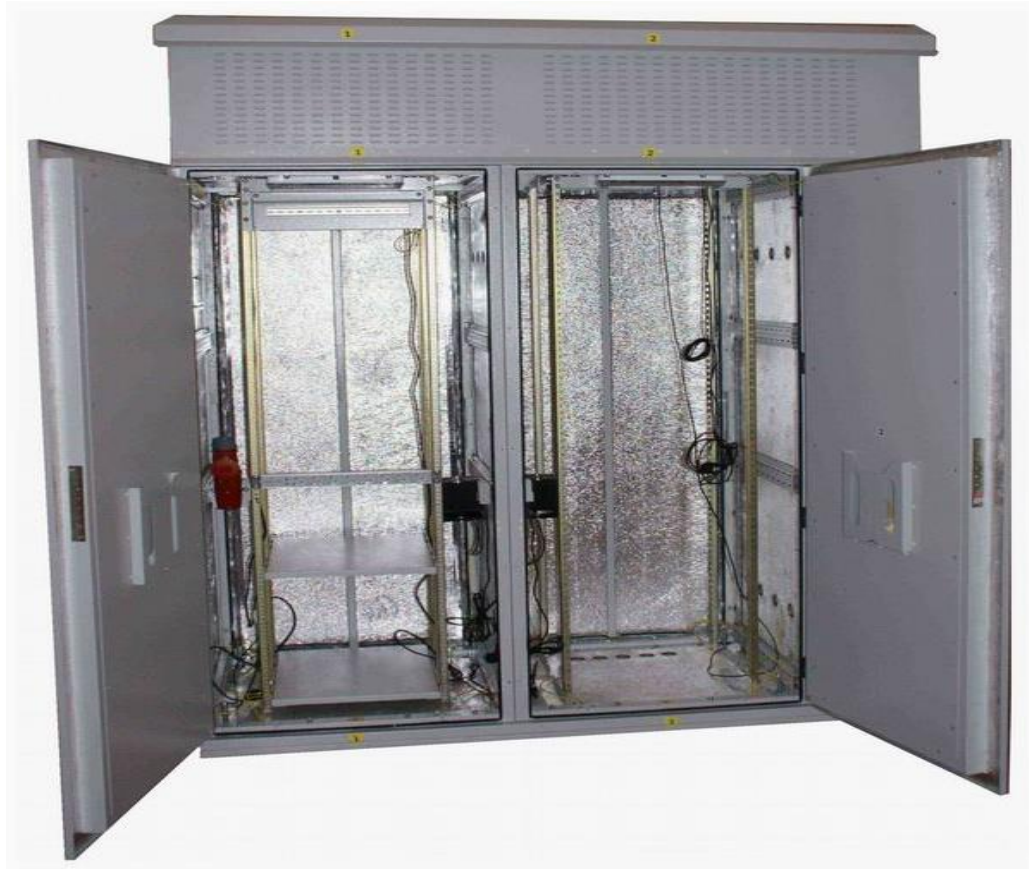
Рисунок 44 – Дорожный коммутационный шкаф.
