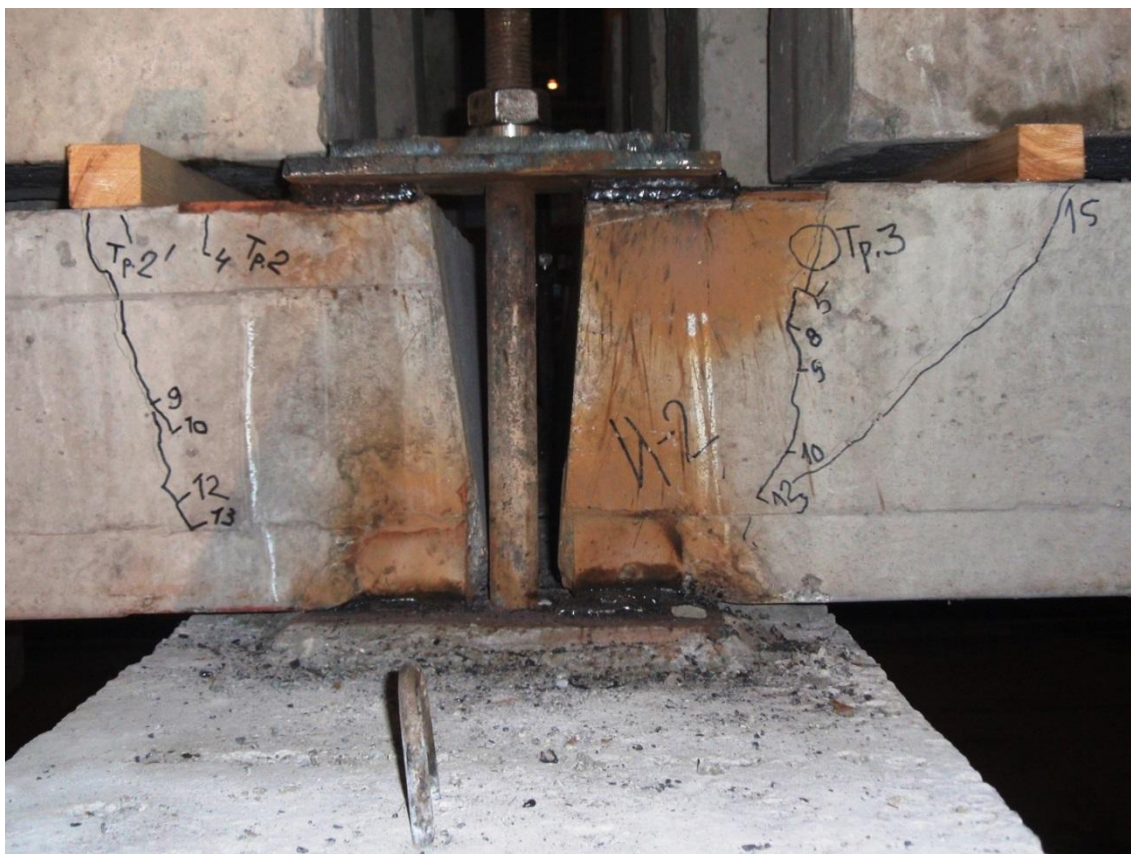
Рис. 3. Разрушение у средней опоры
