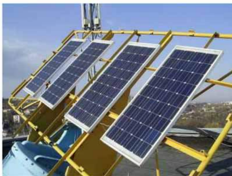
Рисунок 7. Блок солнечной панели на крыше здания.
