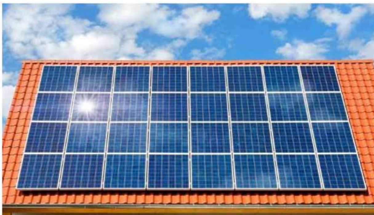
Рисунок 25. Солнечные панели на кровле.
